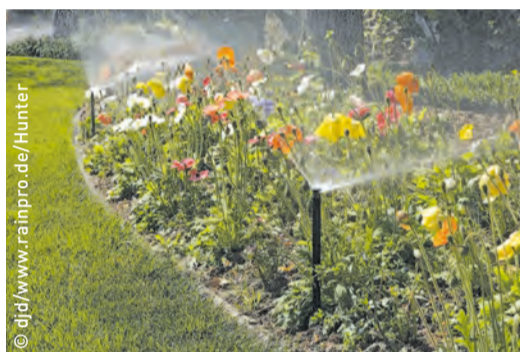
© djd/www.rainpro.de/Hunter Automatische Bewässerungssysteme dosieren das Nass effektiver und sparsamer als der Mensch.
